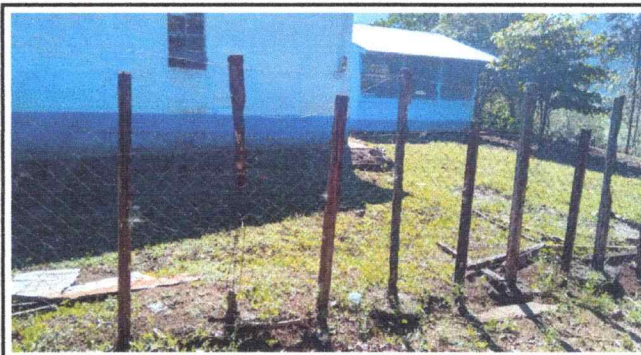
Foto 2: Se observa el deterioro de las bases de los orcones o columnas de las mallas.
