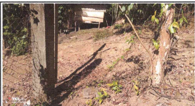
Foto 3: Se observa buen parte de la circulación anterior rotos y caídas en todos los lados.
