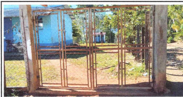
Foto 6: Se observa la oxidación y deterioro de la estructura metálica del portón principal.
